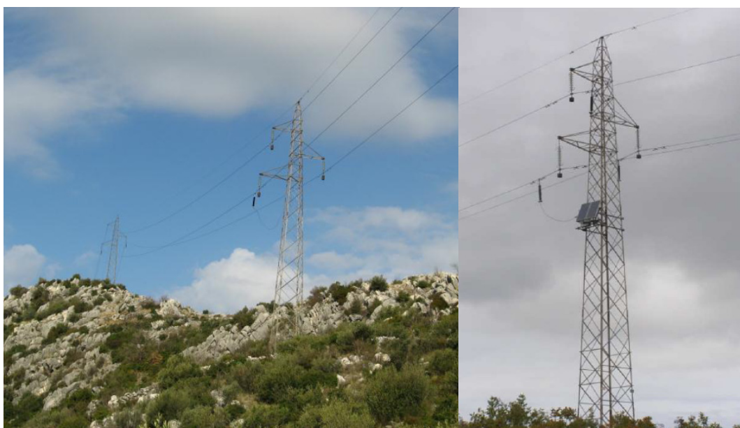
Слика 3.4 – Линијски одводник пренапона без спољашњег искришта постављен у доњој фази 110 kV вода Комолац–Стон [94]
