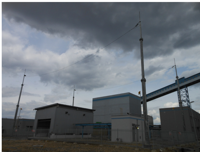
Слика 6.1 – Фотографија екстерног система заштите складишта водоника у ТЕ Станари (РС-БиХ)
